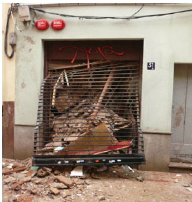
L'ESTABLIMENT DE L'EDIFICI QUE ES VA ENSORRAR VA QUEDAR MOLT MALMÈS
